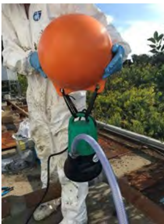
図 3-6 第1水中ポンプと浮きの外観
