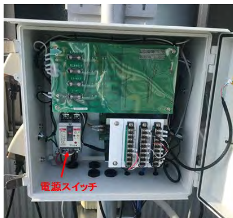
図 3-10 BOD監視システム制御部内部の外観
