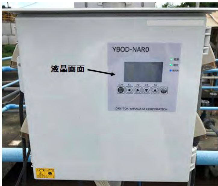
図 3-11 BOD監視システム制御部の外観
