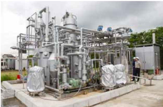
写真2 過熱メタノール蒸気法に基づく実証規模プラントの外観 (生産能力：400L/日)
