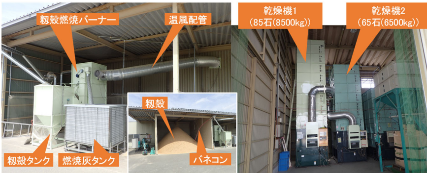
図 3-6 現地農家に設置した籾殻燃焼による穀物乾燥利用システム
