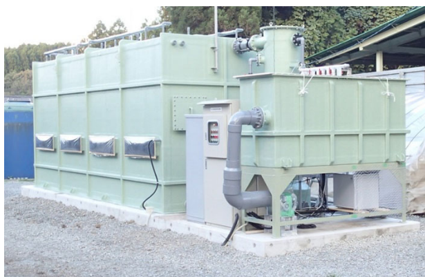
図 3-1 微生物環境制御型脱臭システム 3 号機
