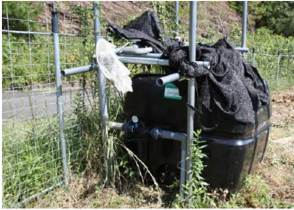
写真VI-1-1 S地区の液肥混入システム
