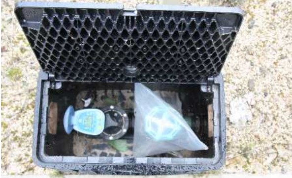
写真VI-4-3 各園地に設置された電磁弁
