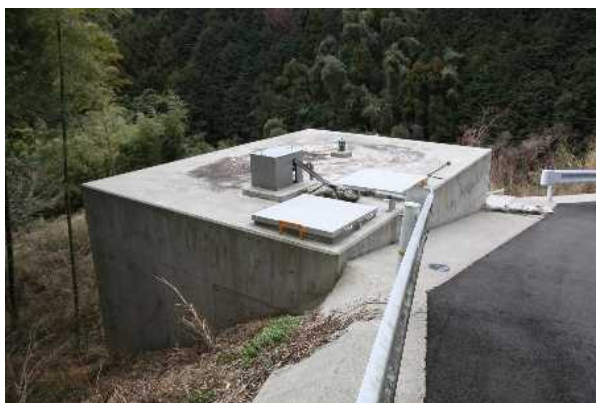
写真VI-4-1 水源の貯水槽
