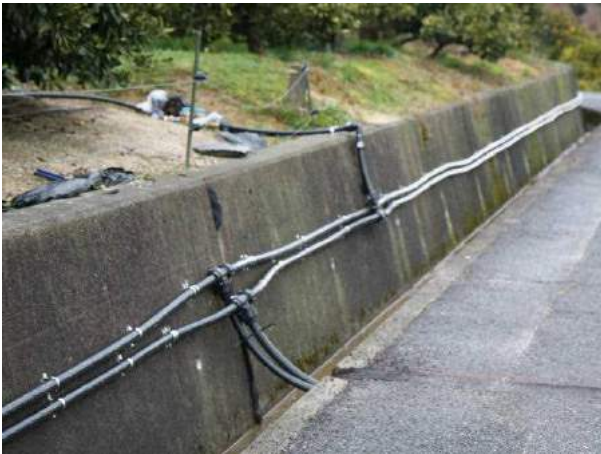
写真VI-3-3 複線式の配管
