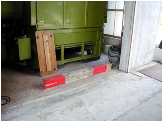
作目： 水稻、穀物 作業： 運搬、乾燥 目的： 作業安全 方法： 糸の張り込み口にトラックが衝突しないように、車止めを設置（□20cmの角材をアンカーボルトで固定）
