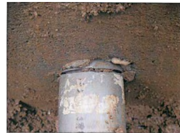
スラスト継ぎ手 周方向のき裂 VP50
