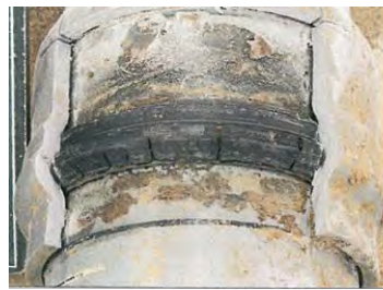
ゴム輪のき裂 VP200 RR管
