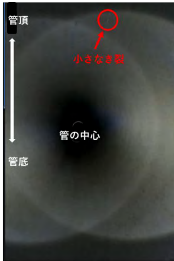
図 22 管内検査用カメラ搭載ロボットが撮影したき裂
