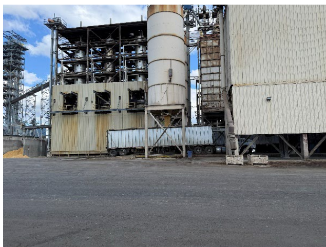
図 21 乾燥・調整後穀物のバラ出荷用 コンテナ充填設備
