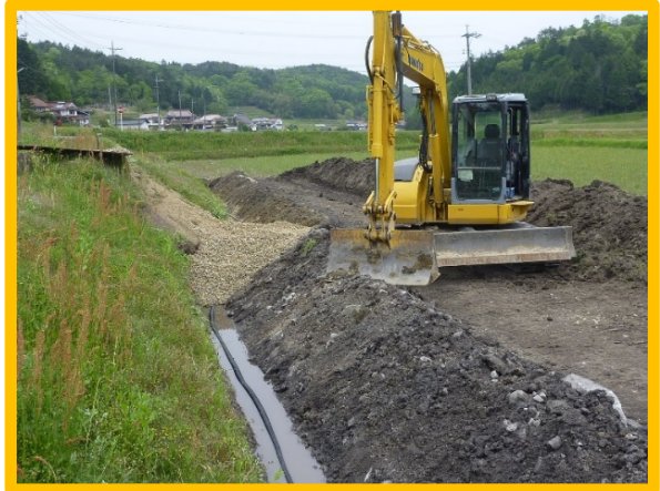
湧水対策の暗渠管設置 圃場の山側から湧水が発生するため、別途山沿いに暗渠管を埋設した。
