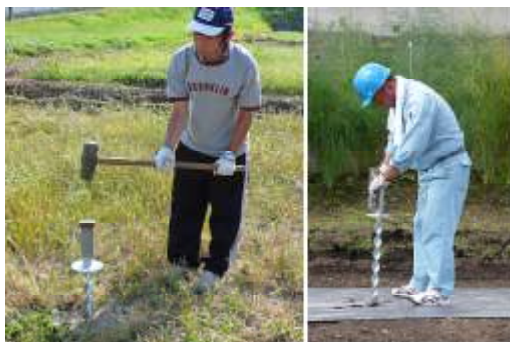
図8 スパイラル基礎杭の設置 打ち込み施工(左)とねじ込み施工(右)
