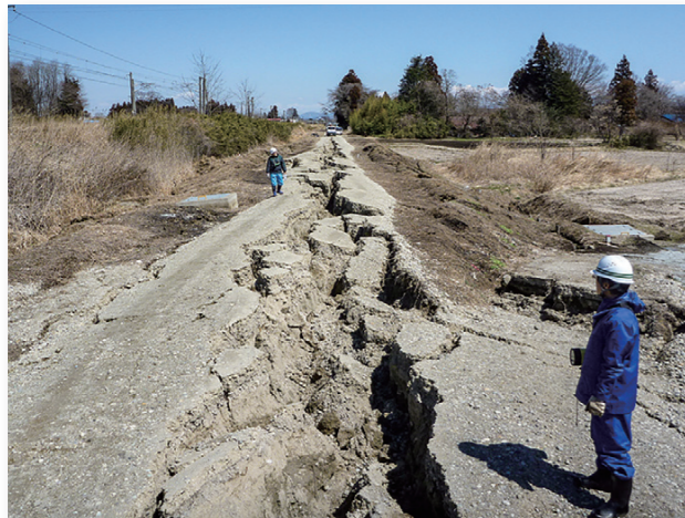
●東日本大震災発生後、被災調査 液状化によって被災したパイプラインの調査を行った
