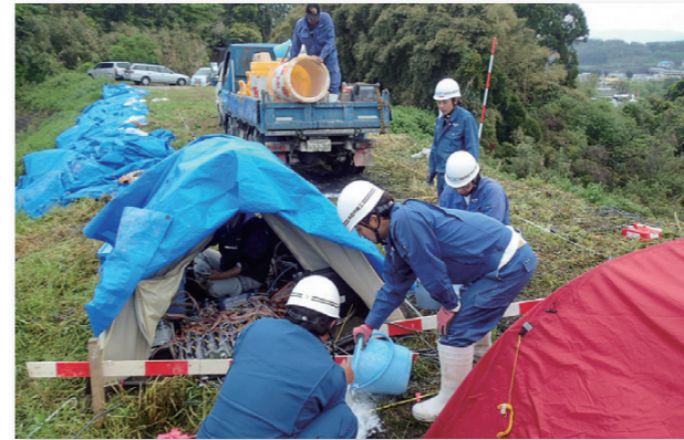
●熊本地震によるため池の被害(上)と、ため池の亀裂の電気探査(下)
