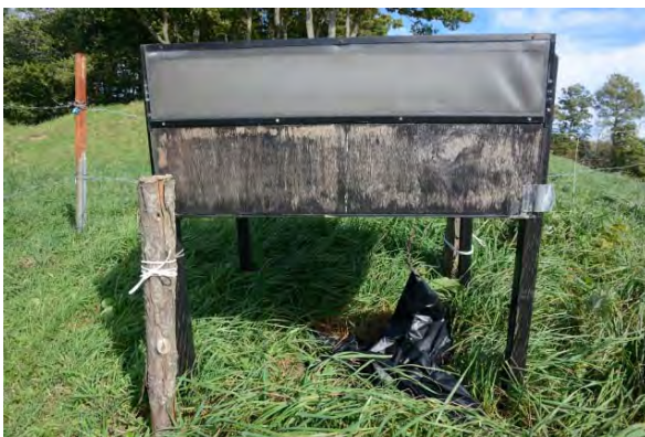
図 3-2-3 塗装が劣化したボックストラップ。
