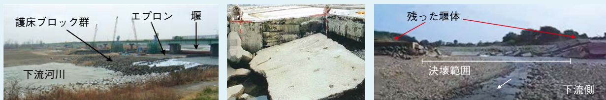
図1 河床低下で護床が傾斜化した堰(左)と被災例(中：エプロン陥没、右：堰決壊)
