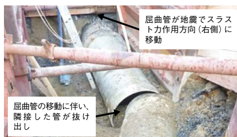
図1 パイプの地震被害の例
