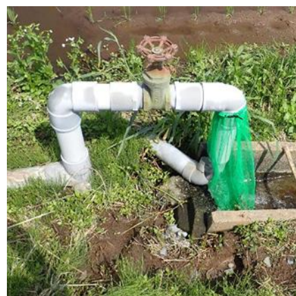
図 I -8 給水栓に設置した収穫ネット
