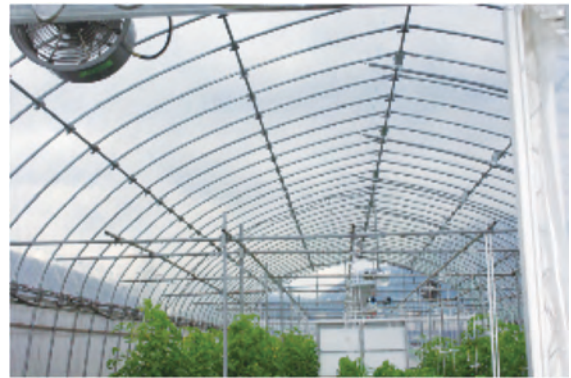
図 10 パイプハウスでの設置状況
