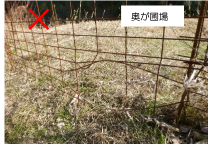
溶接が外れてできた隙間から侵入
