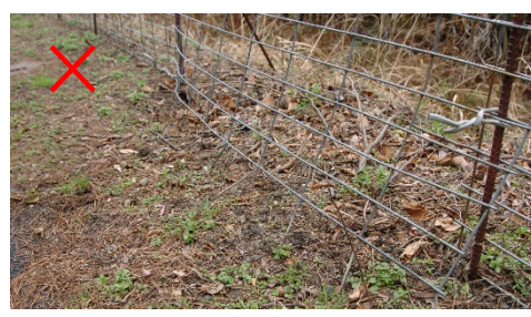
下の隙間から侵入
