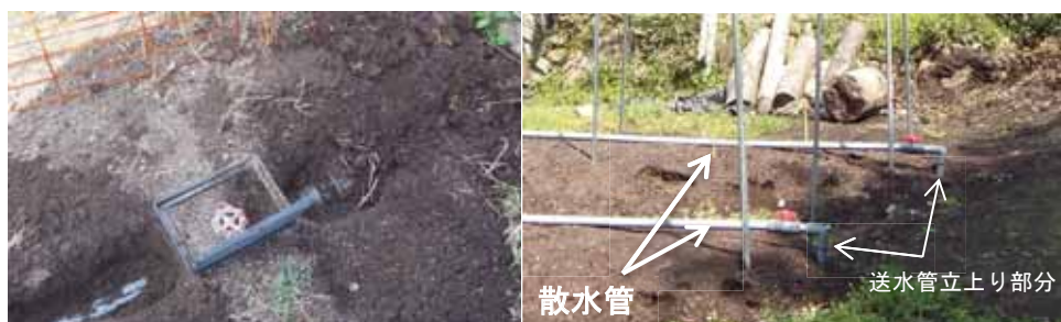
写真2 区画ごとに散水するためのゲートバルブ（左）と散水管（右）
