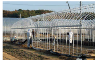
慣行ハウス：アーチパイプの間隔は約0.5mが標準
