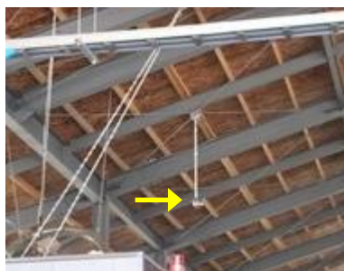
天井に設置したカメラ (矢印)
