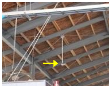
天井に設置したカメラ (矢印)
