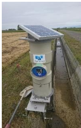
自動給水弁設置写真
