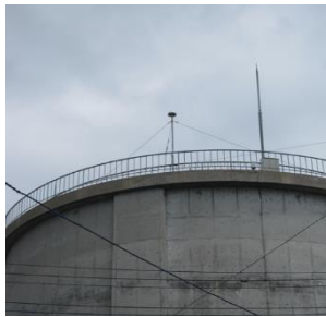
配水タンク上に設置したRTK-GPS基地局
