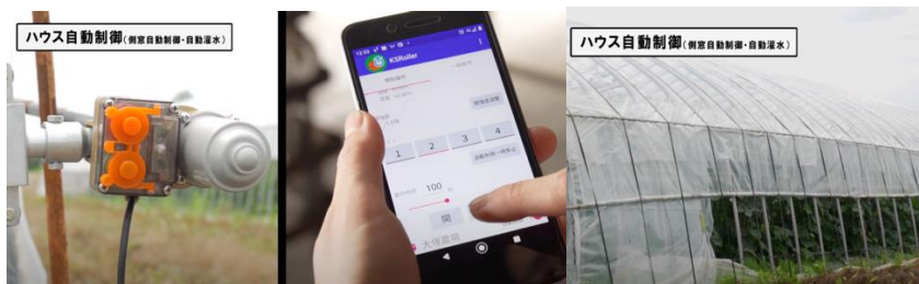
図11 ハウス管理作業設備
