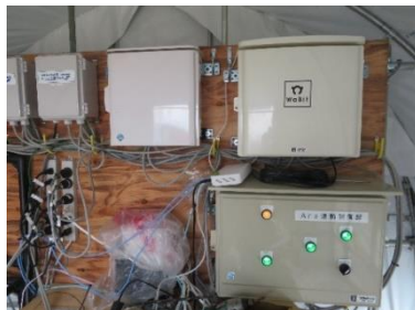
UECSの制御ノード
