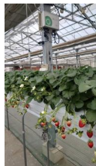
図12 営農管理システム設置状況
