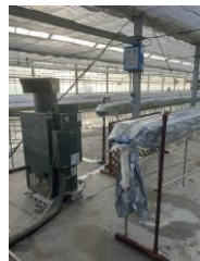
図14 局所CO 2 施用装置設置状況
